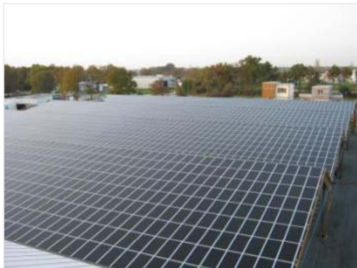
Lieu : La Chaize Le Vicomte (Vendée) Capacité : 432kWc Fournisseur : First Solar Type de bâtiment : Ombrières de parking
