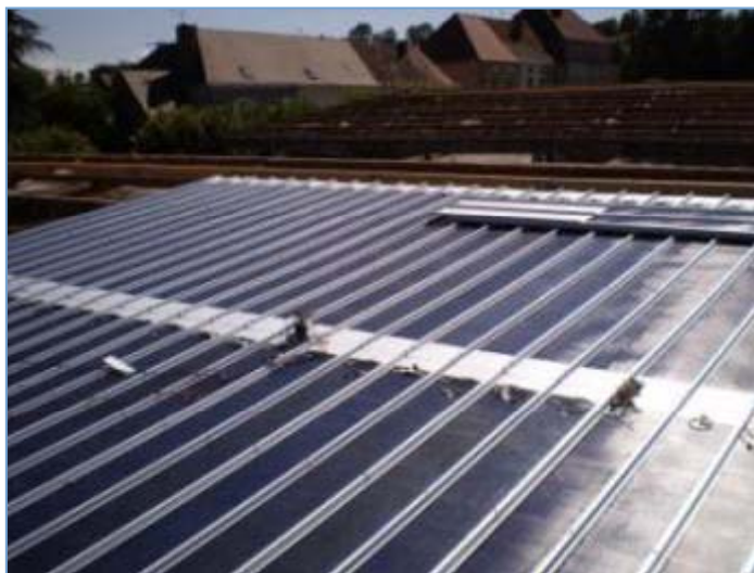
Lieu : Saint-Christophe en brionnais (Saône-et-Loire) Capacité : 406 kWc Fournisseurs: Unisolar et Suntech Type de bâtiment : Marché aux bovins
